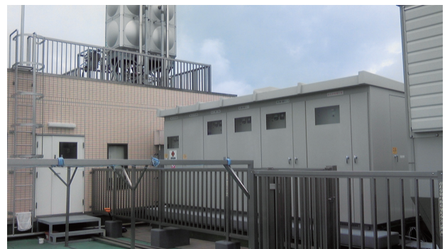
図9 屋上設置の自家発電機
