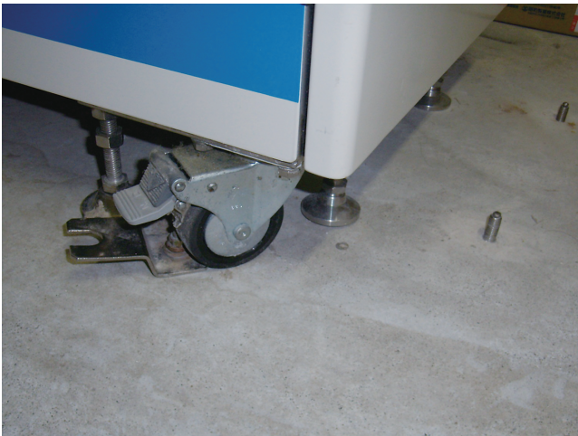
図 5 東日本大震災（震度 7 によるアンカーボルト固定の破損）
