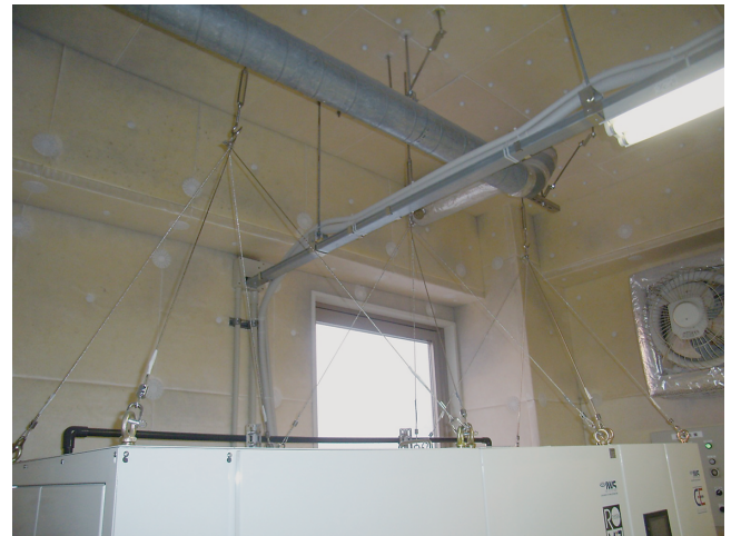
図 6 東日本大震災（震度 7 によるアンカーボルト固定の破損をレスキューした天井つりさげ固定）
