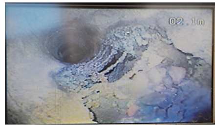
損傷ケース3:取付管
