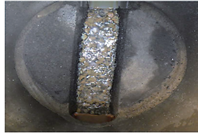
損傷ケース1:汚水ます
