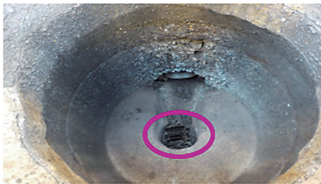
損傷ケース2:汚水ます
