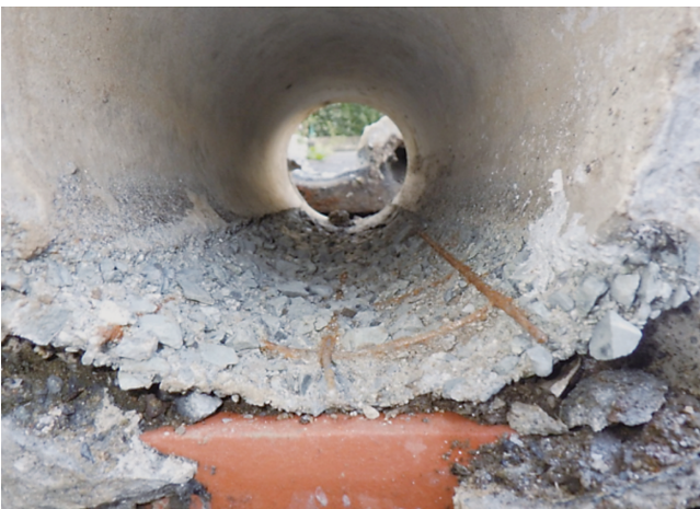
図2 コンクリートの損傷
