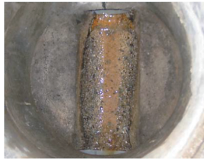
透析排水により損傷した汚水管
