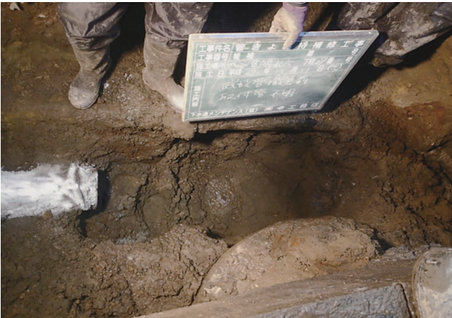
図1 下水道管の消失
