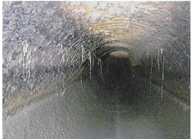
図3 硫化水素による下水管の腐食
